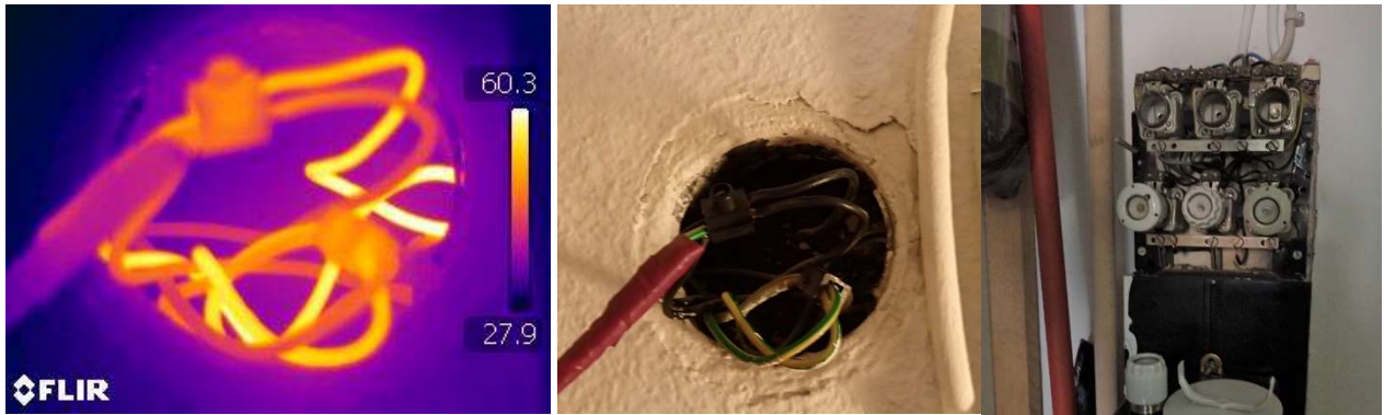
Abbildung 9: Messung der Verteilerdose mit Kupferleitungen vor Ort in Wohnung und 50er Jahre Installation in München
