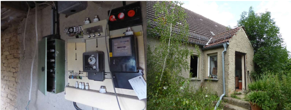
Abbildung 7: Untersuchte Hauselektrik- (Aluminium) aus den 70ern im EFH bei Pasewalk
